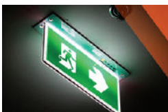
1. Iluminação de emergência
