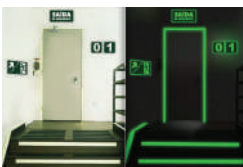
2. Sinalética de emergência
