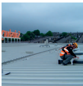
Instalação, certificação inspeção e manutenção de Linhas de Vida
